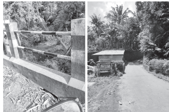
Gambar 13. Kondisi Sungai di Dusun Cakran.
